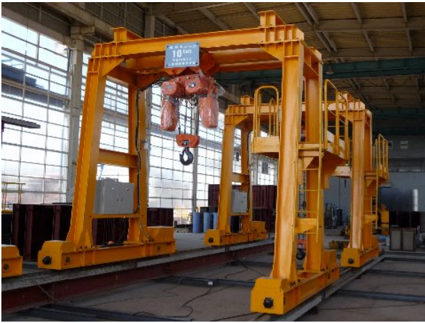
橋形クレーン
