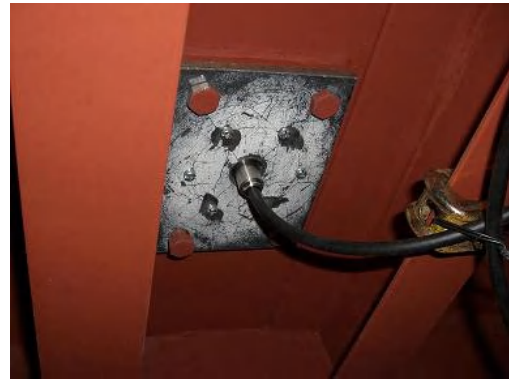
圧力センサー(型枠内側)
